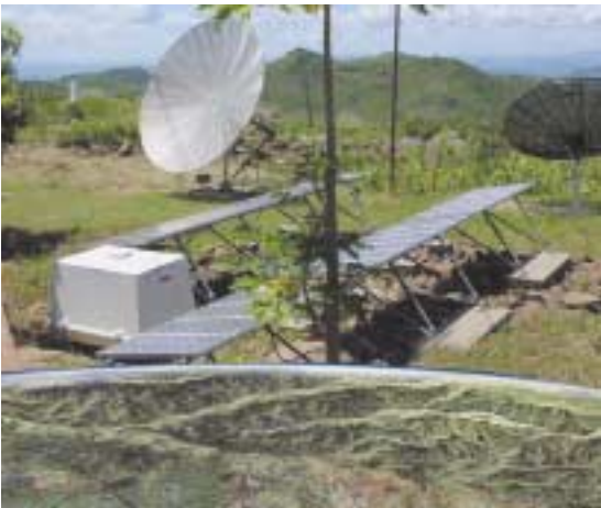
Na extensão às zonas rurais, a TDM tem utilizado o sistema de comunicações VSAT (via satélite com uso de antenas de pequeno diâmetro).
